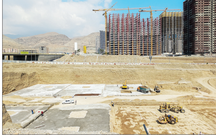
گودبرداری در شمال باغ گیاه شناسی تهران و روبه روی پروژه برج سازی ۴۰ طبقه که زمستان سال گذشته متوقف شده بود
